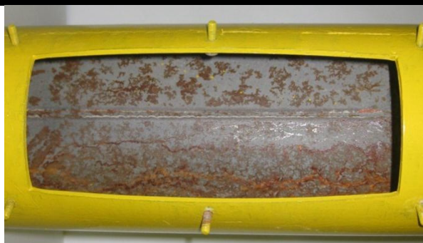
Рис. 1. Деформация корпуса верхней помольной камеры
